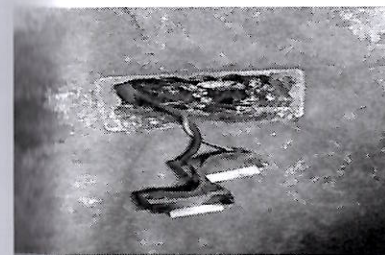
常見缺失樣態 -1.電線未確實接牢並固定。
