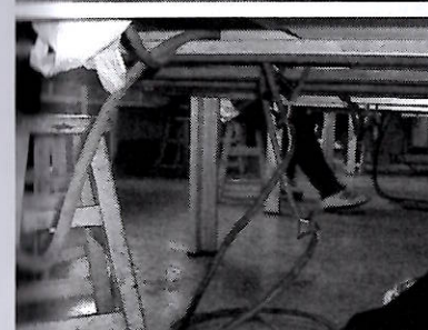
常見缺失樣態 -3.桌下電線接續處僅用膠帶纏繞(未再加一層保護)
